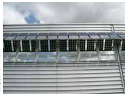
Pare soleil photovoltaïque, bâtiment Total Energie
